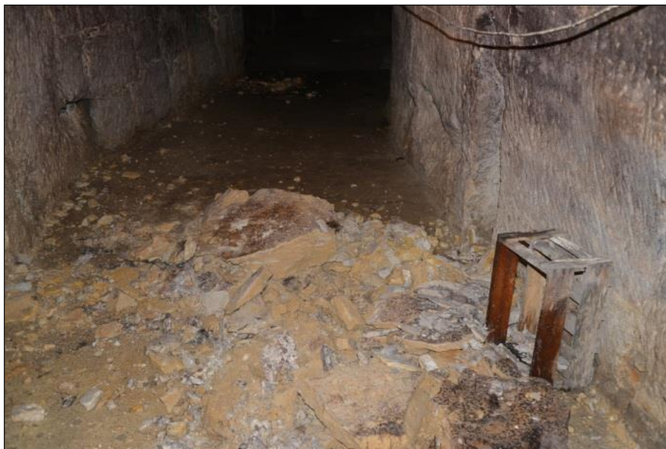
Abb.1 : Großflächiger Firstfall im Südgang
