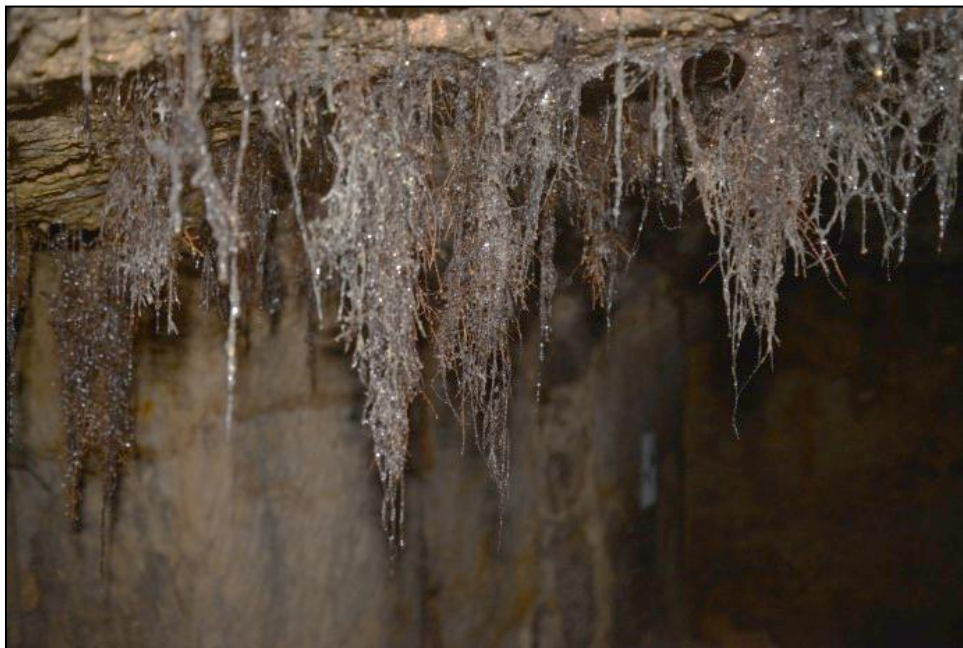
Abb.2 : Durchwurzelte und durchnässte „Pflanzentone“ führen im Firstbereich zu Gesteinsablösungen
