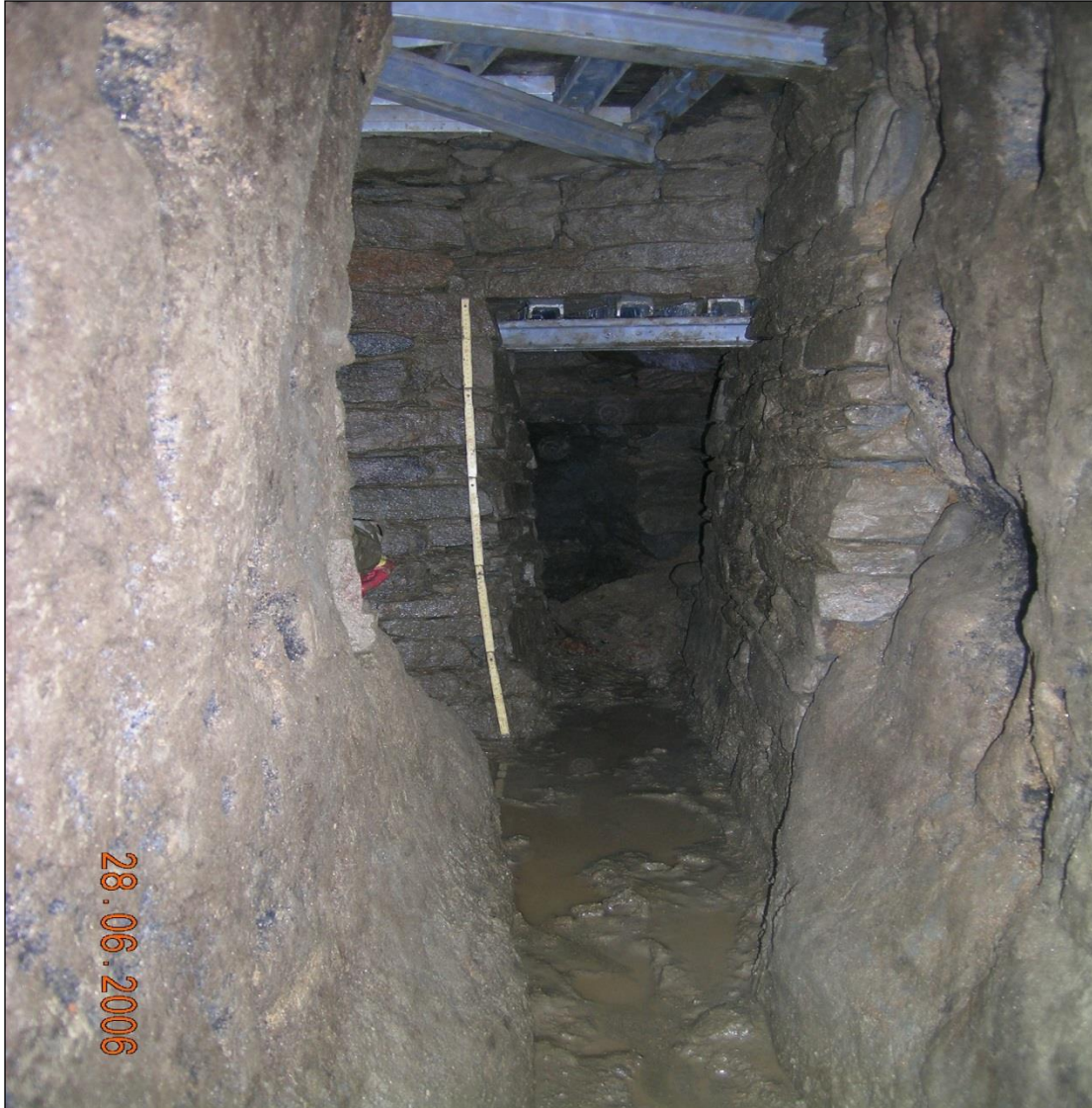
Abb.6 : Gesicherte Firste durch verzinkte Stahlträger (Anzucht Burgstraße)
