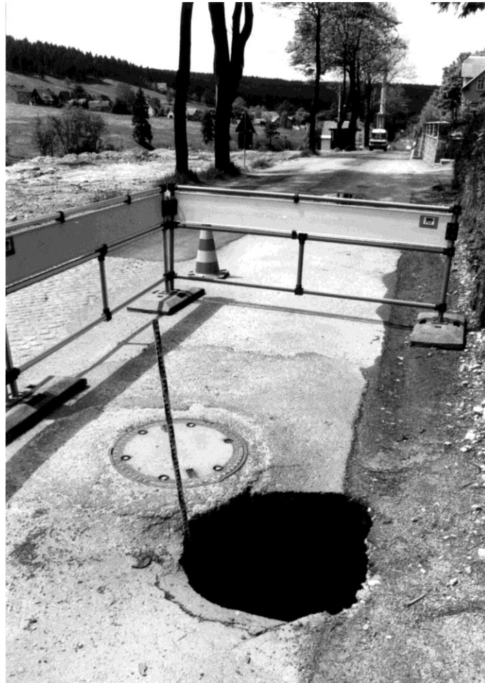
Abb.3 : Tagesbruch im Straßenbereich
