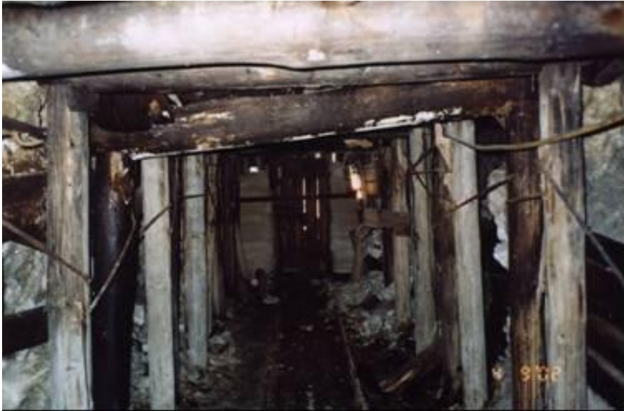
Abbildung 6: Nachbruchgefährdeter Mundlochbereich der 20-m-Sohle zum Westtagebau
