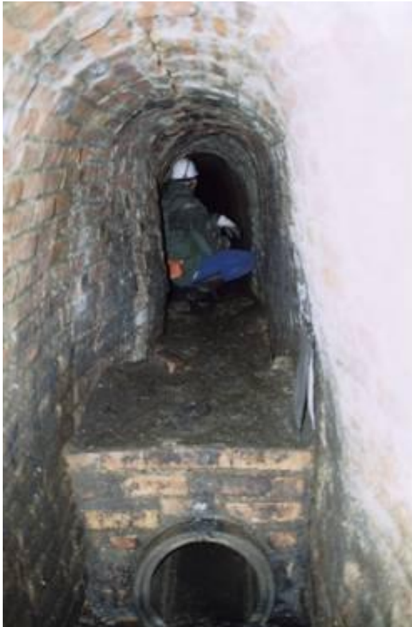
Abbildung 7: Der Tiefe Stollen im Niveau der 22-m-Sohle wurde teilweise für die Abwasserleitung benützt. Das Ziegelgewölbe zeigte partiell starke Deformationen
