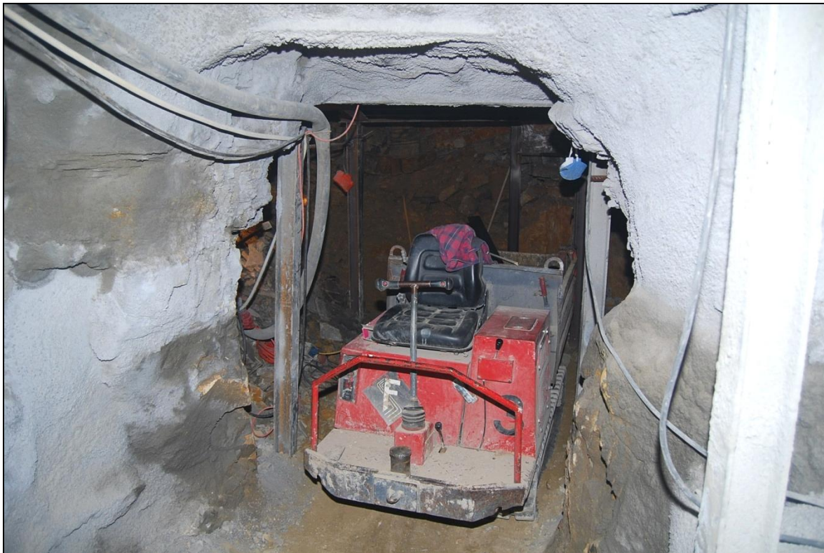
Bild 5: Aufwältigungs- und Sicherungsarbeiten in den teilverbrochenen Grubenbauen mittels Kleintechnik. Die Streckensicherung erfolgt mit Spritzbeton.
