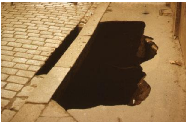
Bild 2: Tagesbruch (1981) im „Steinweg“ in der Altstadt von Gera.
