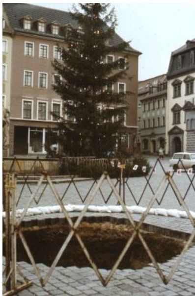
Bild 1: Tagesbruch (Dezember 1989) durch verbrochenen Höhler auf dem Marktplatz von Gera.
