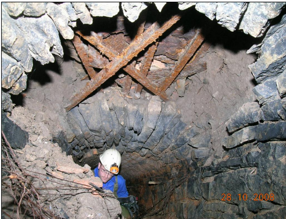
Abb.2 : Teilverbrochener Stollen unter der Parkanlage des Novalis-Schlusses
