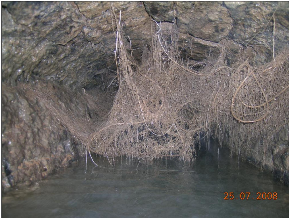
Abb.4 : Durch Pappelwurzeln vollständig verschlossener Stollenquerschnitt (luftseitig)
