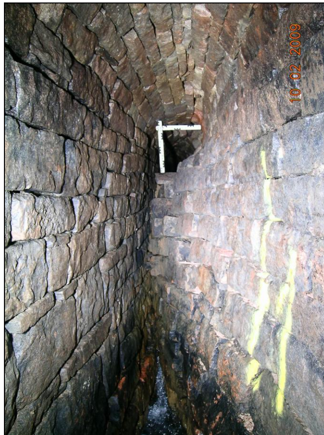
Abb.3 : Stollenverschluss durch Deformation des Natursteinausbaues
