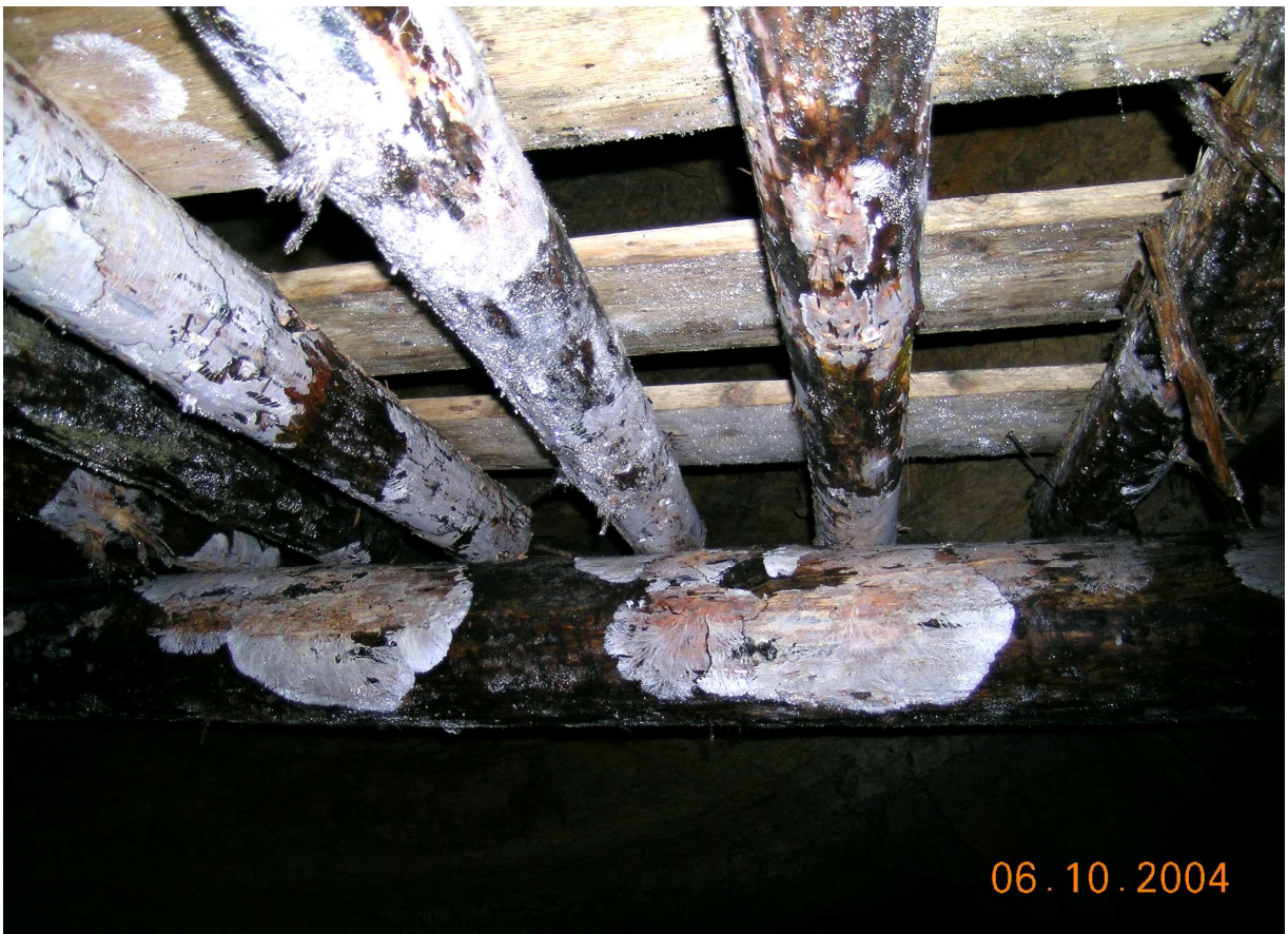
Abb.1 : Intensiver Pilzbefall eines hölzernen Sicherungsausbaues in Grubenbauen des Zechsteinkalkes nach ca. 1 Jahr Standzeit.
