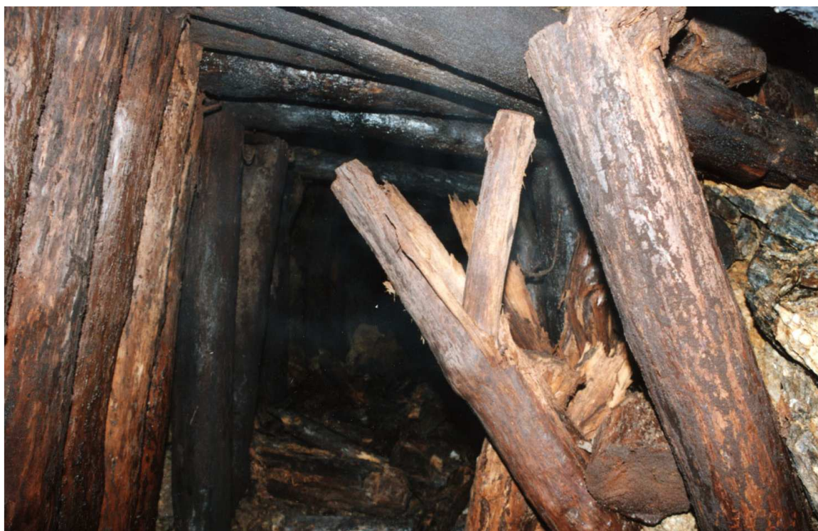
Abb.2 : Massiv in Holz ausgebaute und deformierte Strecke im alten Uran-Bergbau des Erzgebirges. Das Holz erfüllt keine nennenswerte Funktion mehr (Holzalter ca. 60 Jahre).
