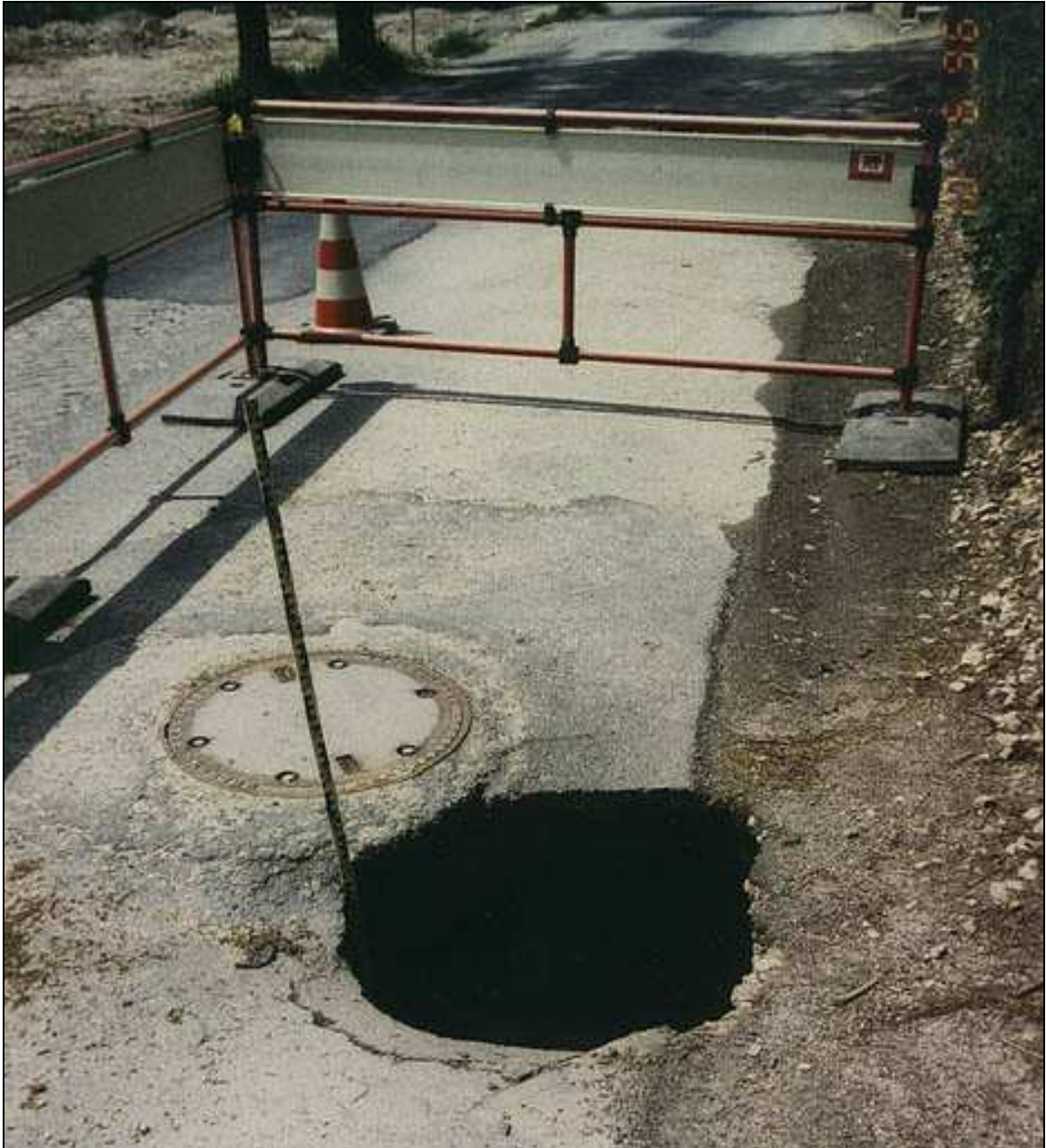
Abb. 3: Tagesbruch im Straßenbereich
